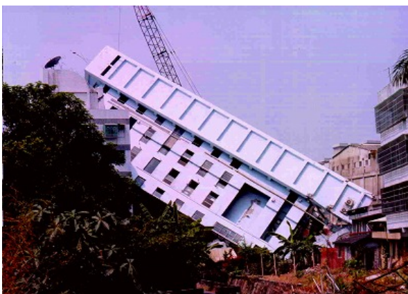
写真9: 倒壊した12層の事務所ビル
