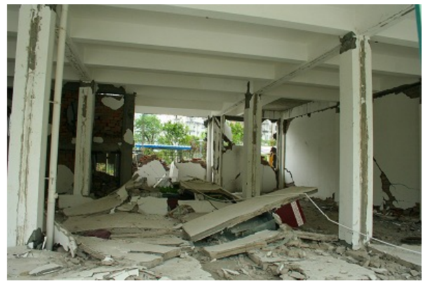
写真7: 柱頭、柱脚にヒンジが形成された建物
