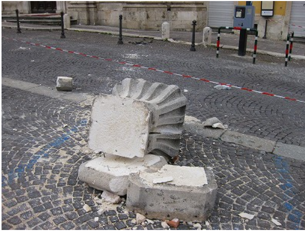
写真4: 装飾物の落下
