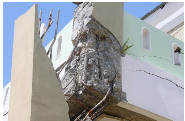
写真12: 柱主筋の接合部からの抜けだし
