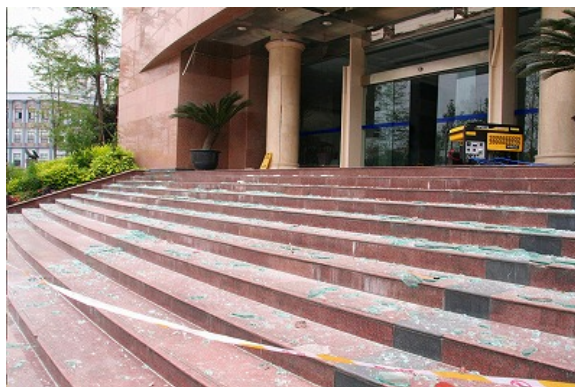
写真3: 損傷したガラスの落下状況
