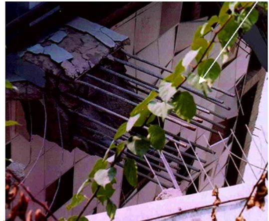
写真10: 抜け出した主筋
