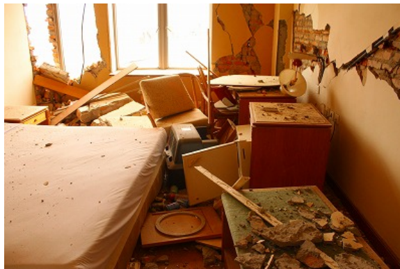
写真1:ホテルの間仕切り壁(レンガ造)の損傷
