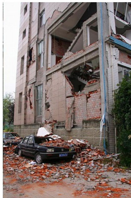
写真2:外壁(レンガ造)の崩落
