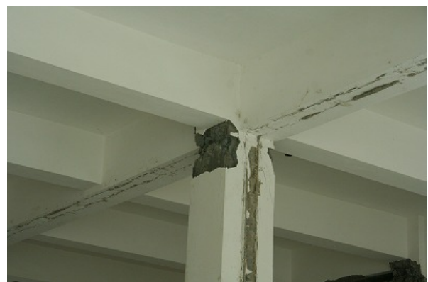
写真8: 柱頭の損傷状況
