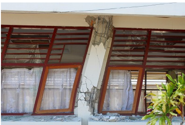
写真6: 主筋量の少ない柱の損傷
