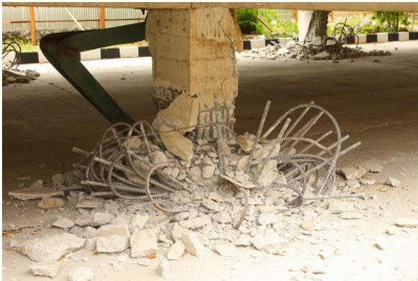
写真5: 主筋量の多い柱の損傷
